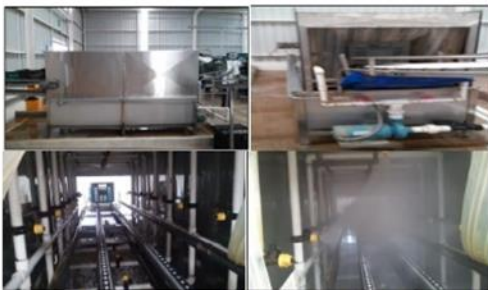
Figura 2. Lavado de contenedores de cajas de plástico. Sistema de aspersión de agua.
