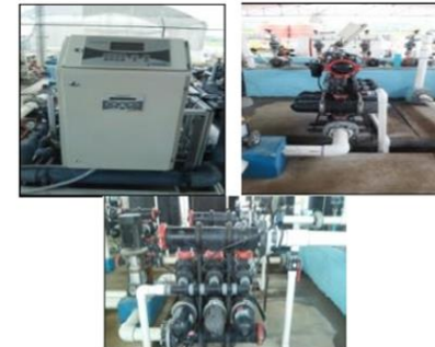
Figura 7. Sistema de riego automatizado.
